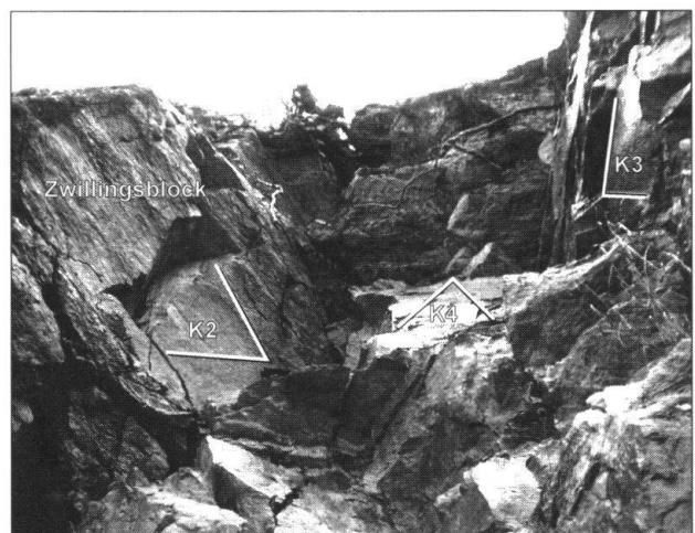
Fig. 17: Felsackungsmasse mit Ausbruchsnische von 1998 (Kreis), wo ein Felssturz von 20 m³ aus 30 m Höhe die Ponte Scalascia VI beschädigte. Die Ausbruchsnische zeigt eine hohe Felszerlegung (unten).
