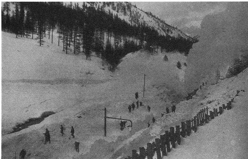
«Crasta-Mora»-Lawine Dezember 1919. Räumung der Bahnlinie mit der Schneeschleuder. Man beachte die Höhe des Lawinenschnees über dem Geleise. Foto RhB
