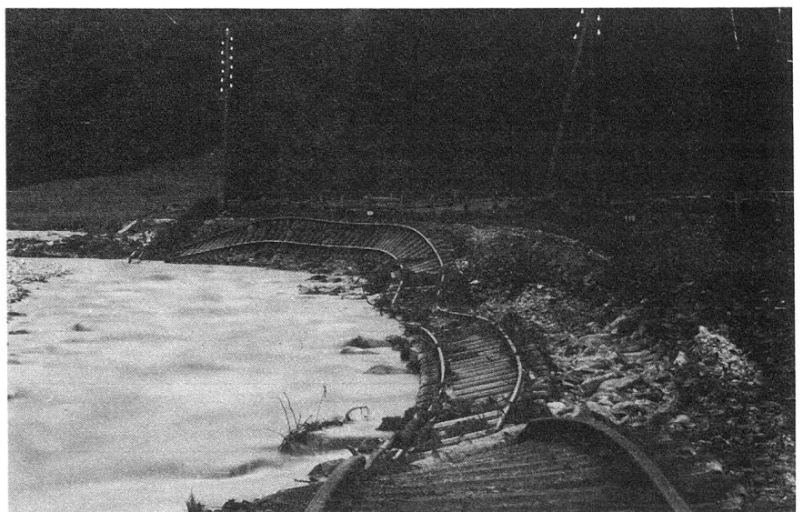
Hochwasser 1910. Hier hat das Hochwasser der Landquart gründliche Arbeit geleistet. Bei Fideris wurde der Damm der RhB unter dem Geleise weggespült.
