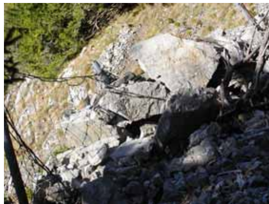
Abb. 4.5: Durch Felssturz aufgefülltes Schneenetze. Die Wirkungshöhe ist reduziert.
