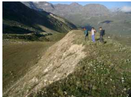
Abb. 4.10: Oberflächenerosion an einem Lawinenablenkdamm auf dem Simplonpass. Falls langfristig kein Unterhalt erfolgt, werden die Tragsicherheit und die Gebrauchstauglichkeit reduziert.
