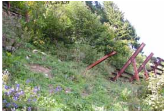
Abb. 4.2: Durch Steinschlag weggerissene und zerstörte Stützwerke (Gefährdungsbild 3). Es handelt sich um einen lokalen Schaden.
