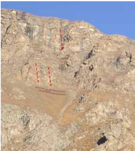
Abb. 3.1: Stützverbauung, die weniger als 20% der potentiellen Anbruchfläche abdeckt. Zusätzlich besteht Steinschlaggefahr.
