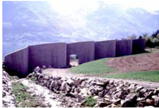
Abb. 4.8 Lawinenauffangmauer aus Beton in Bleie, Ullensvang, Norwegen (Höhe 10 m, Wanddicke 0.35 m), Foto: T. Faug.
