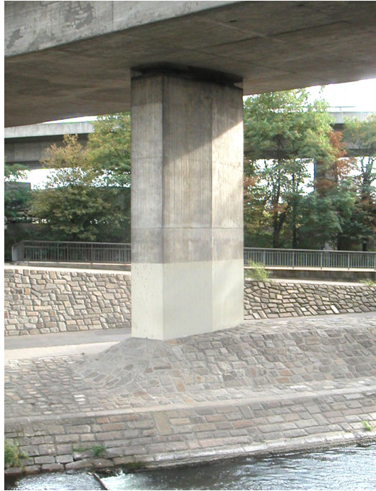
Bild 4.5: Stark reduziertes horizontales Verformungsvermögen der Stütze infolge der massiven Pflasterung des Flussbords
