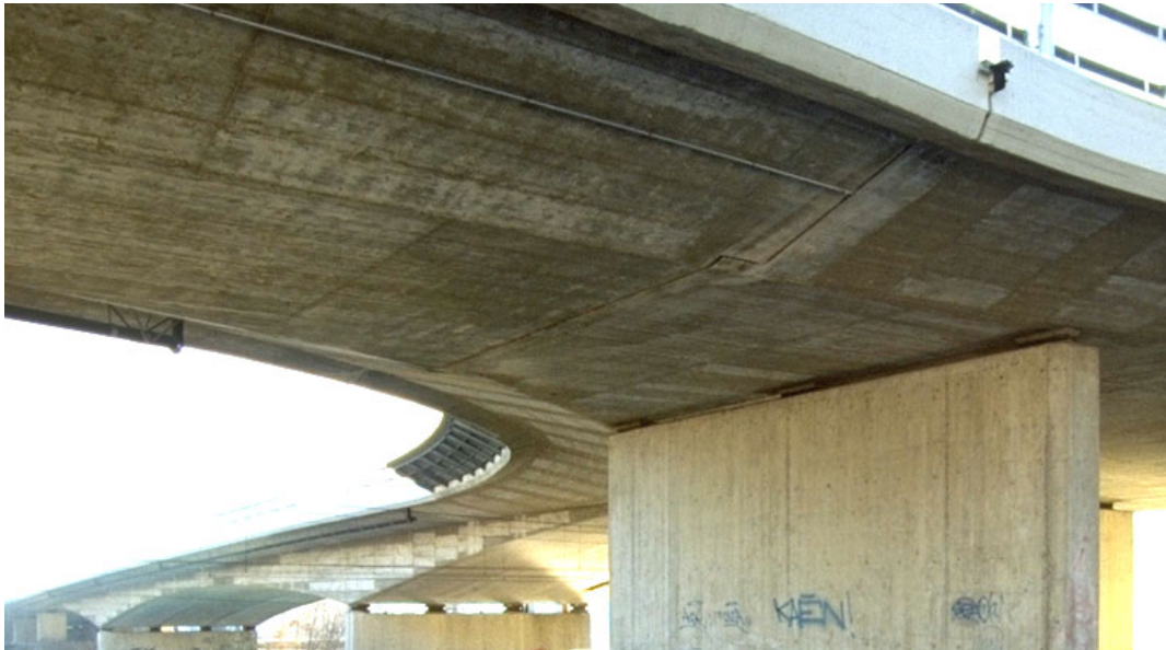
Bild 4.2: Gerbergelenk mit ungünstig kurzer Auflagerlänge
