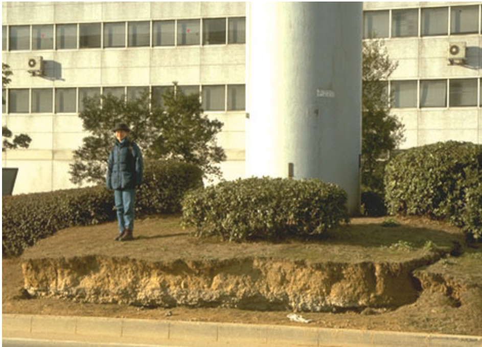
Bild 3.13: Grossflächige Setzungen infolge Bodenverflüssigung um die Pfahlkopfplatte einer Brückenstütze, Kobe 1995.
