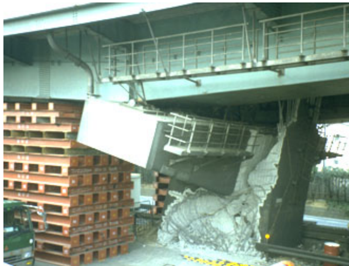
Bild 3.6: Schubversagen einer Stahlbetonbrückenstütze beim Erdbeben von Kobe 1995
