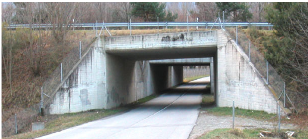
Bild 6.1: Bei der 1. Stufe der Beurteilung werden im Boden eingebettete, monolithische Rahmenbrücken als genügend erdbebensicher ausgeschieden
