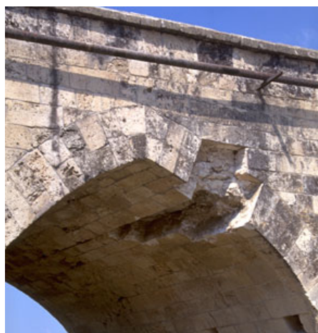
Bild 3.7: Beschädigte Naturstein-Bogenbrücke beim Erdbeben von Ceyhan in der Südtürkei 1998
