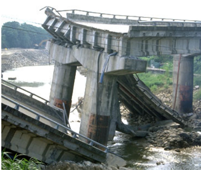
Bild 3.2: Absturz der Brückenträger einer vorfabrizierten Balkenbrücke beim Erdbeben in Taiwan 1999
