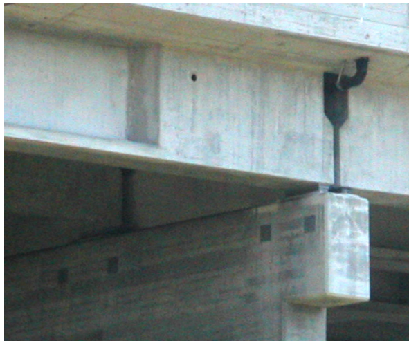
Bild 4.4: Zwischenfuge über einer Stütze mit Gefahr des Trägerabsturzes in Längs- und Querrichtung
