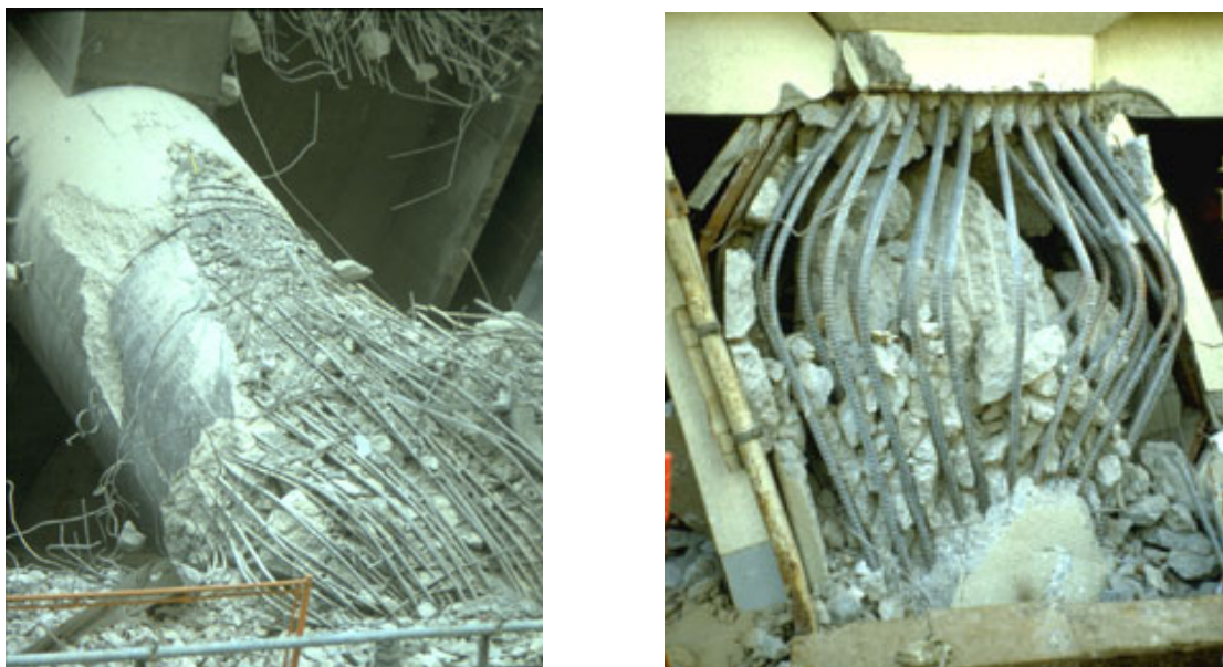
Bild 3.4: Einsturz von Stahlbetonbrückenstützen beim Erdbeben von Kobe 1995
