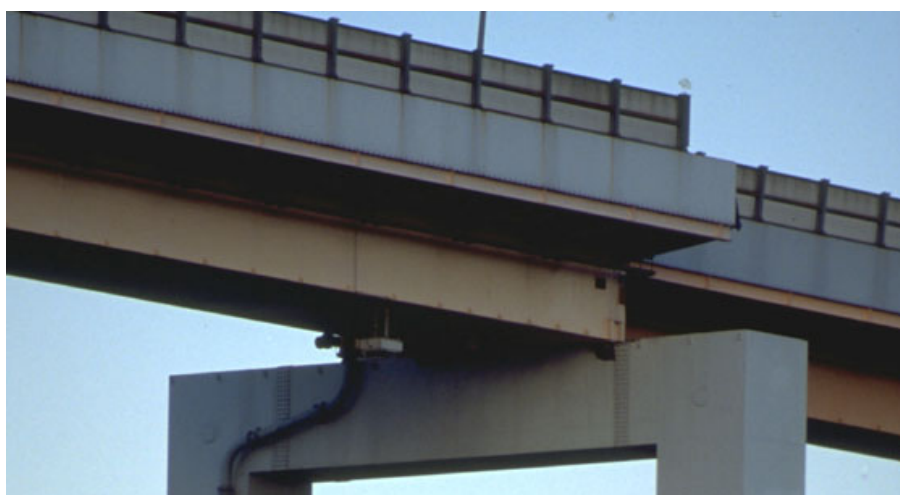
Bild 3.3: Brückenträger seitlich verschoben und von den Lagern auf das Stützenjoch gefallen, Kobe 1995
