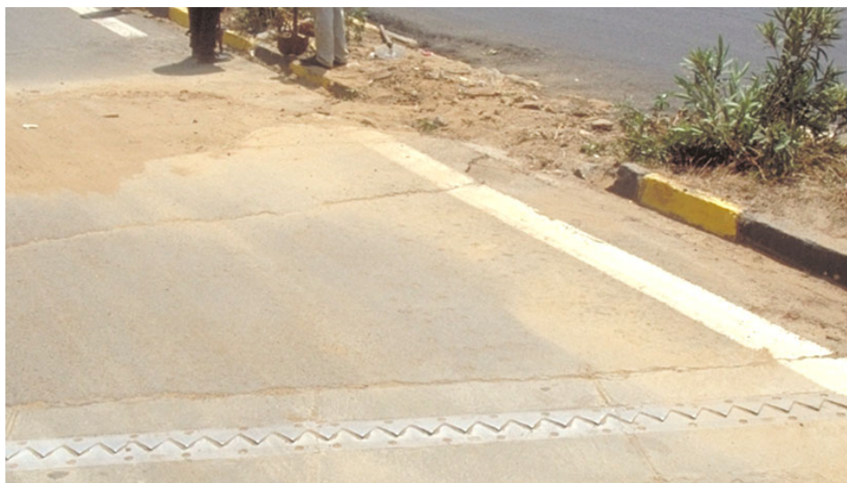
Bild 3.12: Geringfügige Setzungen hinter dem Widerlager einer Strassenbrücke in Boumerdès, Algerien 2003.
