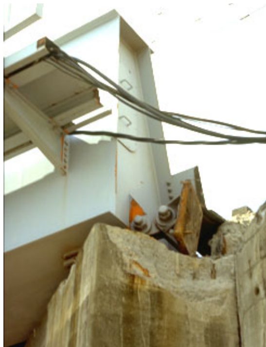
Bild 3.8: Abgerissenes Längslager auf dem Widerlager einer Balkenbrücke, Kobe 1995.
