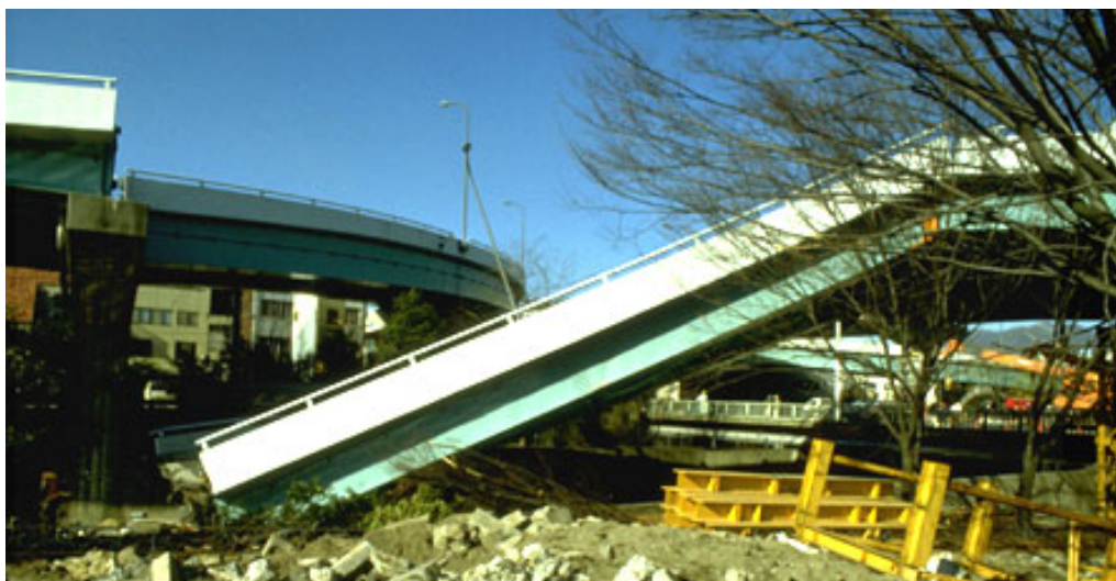
Bild 3.1: Absturz eines Brückenträgers beim Erdbeben von Kobe 1995
