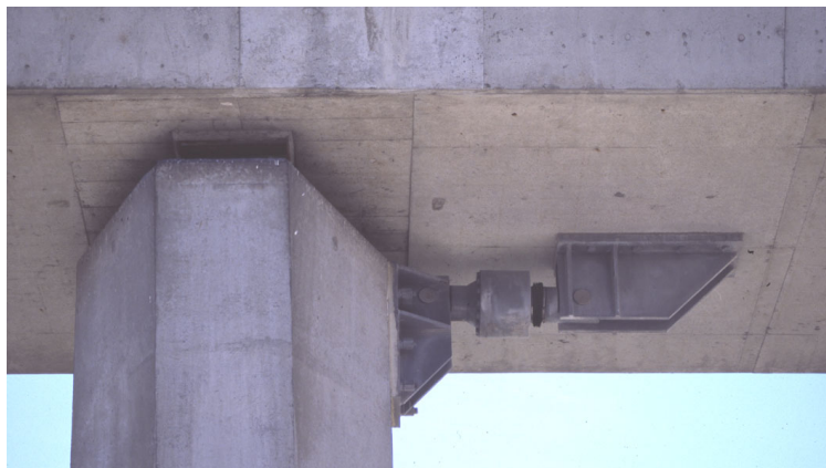
Bild 4.8: Dämpfer eingebaut zwischen Brückenträger und Stütze mit längsverschieblicher Lagerung
