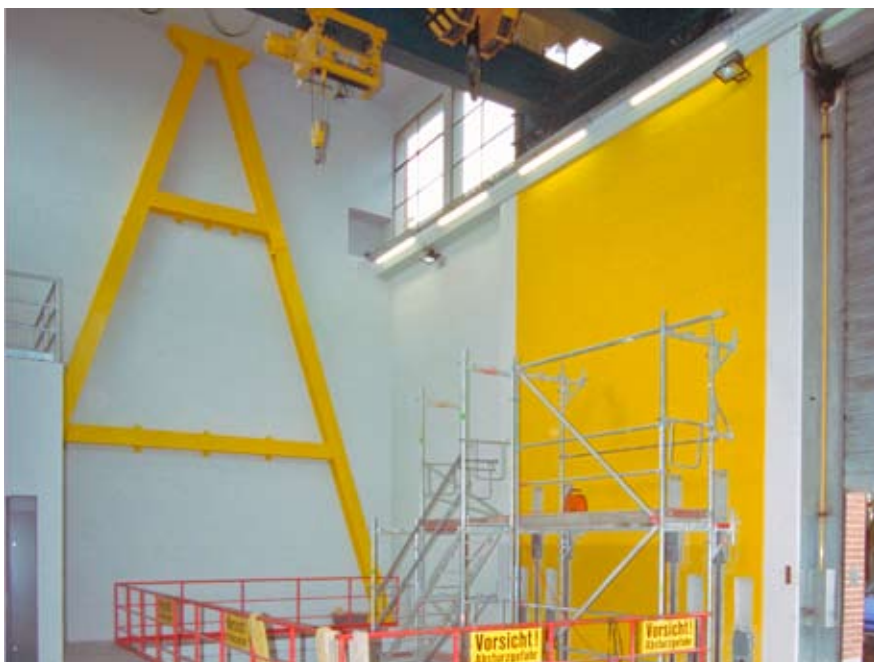
Neues Fachwerk in der Westfassade und neue Stahlbetontragwand in der Nordfassade der Montagehalle.
