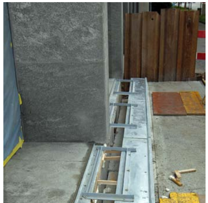
Rings um das Gebäude wird eine Dilationsfuge eingebaut, damit eine freie, horizontale Schwingung auf den neuen Erdbebenlagern möglich wird.
