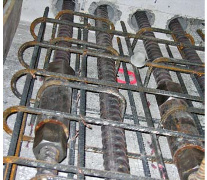
Detail der vertikalen Bewehrungsstösse in den Aufdoppelungen.
