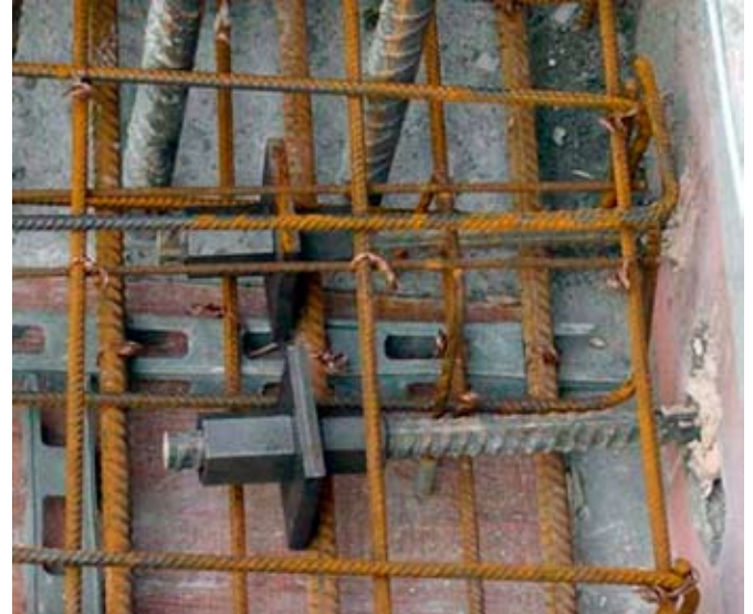
Verankerung des Liftkerns mit Swiss-Gewi-Stangen und eingeklebter Verteilbewehrung in den bestehenden Stahlbetondecken.
