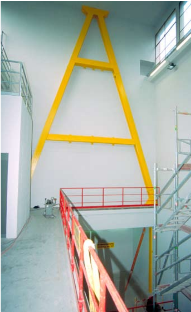
Neues A-förmiges Stahlfachwerk im Erdgeschoss der Westfassade und neue Stahllamellen im Untergeschoss.
