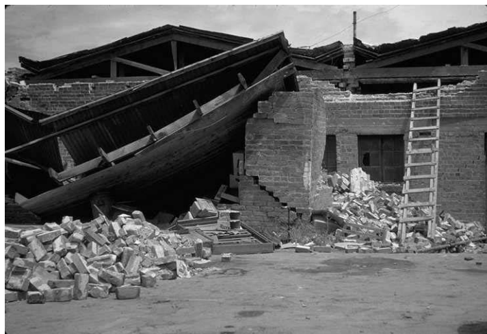
Bild 1: Eingestürztes Gebäude aus unbewehrtem Mauerwerk
