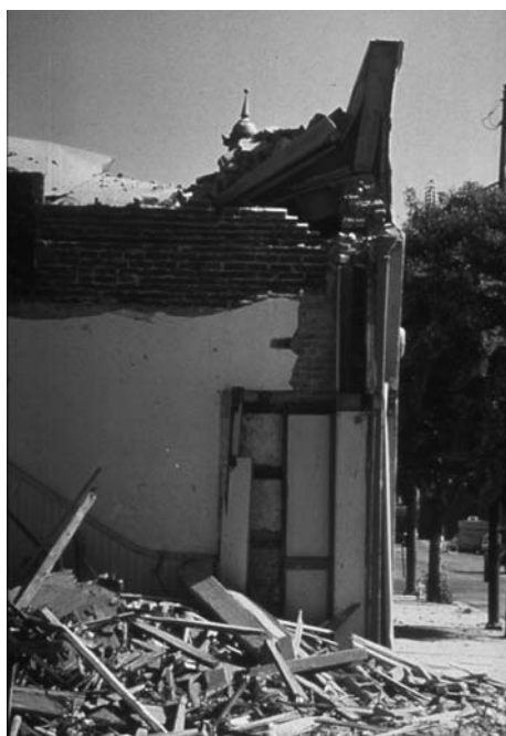
Bild 1: Zerstörtes Wohnhaus aus unbewehrtem Mauerwerk
