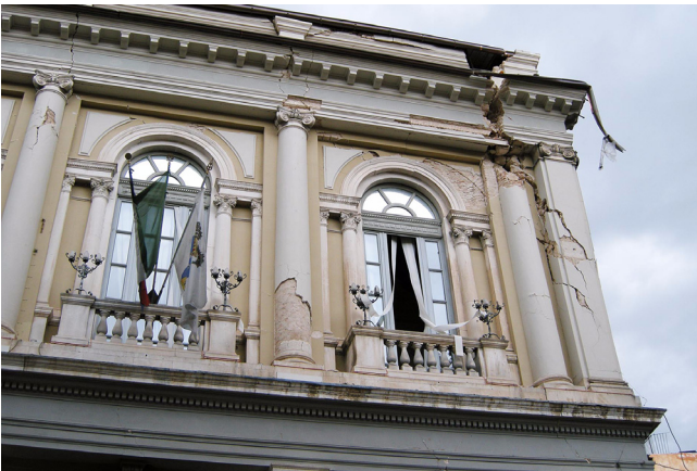
Abb. 7: Wohnpalast im Stadtzentrum von L'Aquila mit Versagensmechanismus aus der Ebene.
