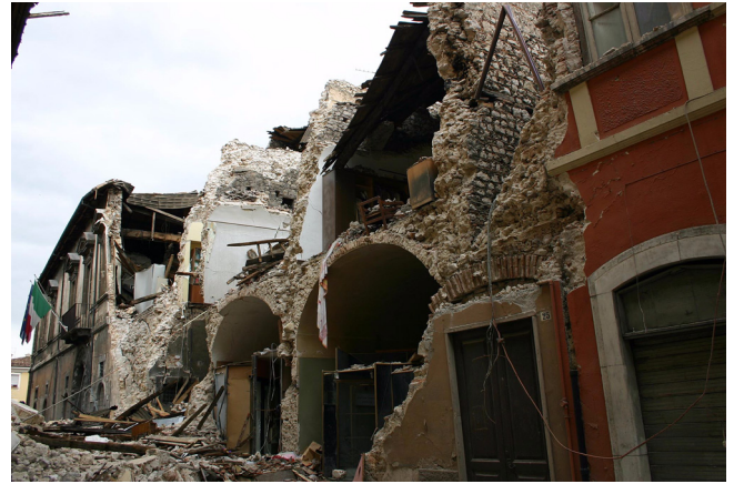
Abb. 16: Stabil gebliebene Bogenstruktur in einem Bruchsteinmauerwerksgebäude im Stadtzentrum von L'Aquila.
