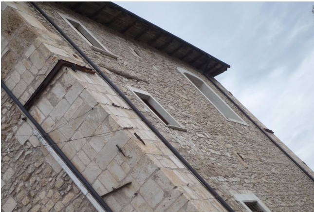
Abb. 15: Chiesa parrocchiale in Paganica: Verankerungen von Zugstangen und Verstärkung der Ecken (Bild: F. Braune).
