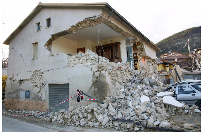
Abb. 19: Wohnhaus aus Bruchsteinmauerwerk bei dem trotz Ringbalken und steifen Decken Versagen aufgetreten ist.
