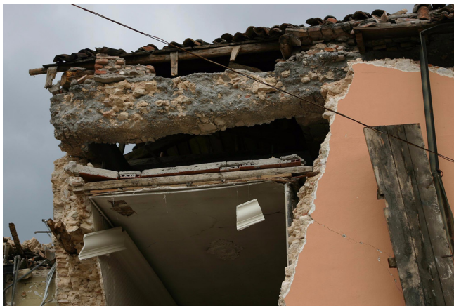
Abb. 18: Nahaufnahme des Ringbalkens des Gebäudes, das in Abb. 17 dargestellt ist.
