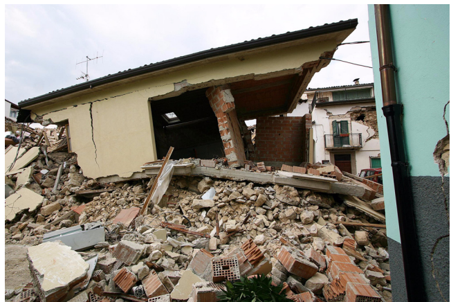
Abb. 20: Gebäude mit einem Erdgeschoss aus Bruchsteinmauerwerk und einem Obergeschoss aus modernem Ziegelsteinmauerwerk mit Decke und Dach aus dem SLC-Deckensystem.
