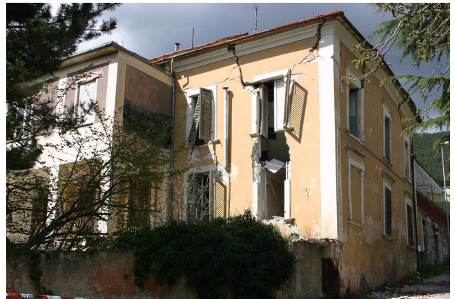
Abb. 9: Schwer beschädigtes Wohnhaus aus Bruchsteinmauerwerk neben einem praktisch unbeschädigtem Gebäude aus Stahlbetonrahmen mit Mauerwerksausfachung.
