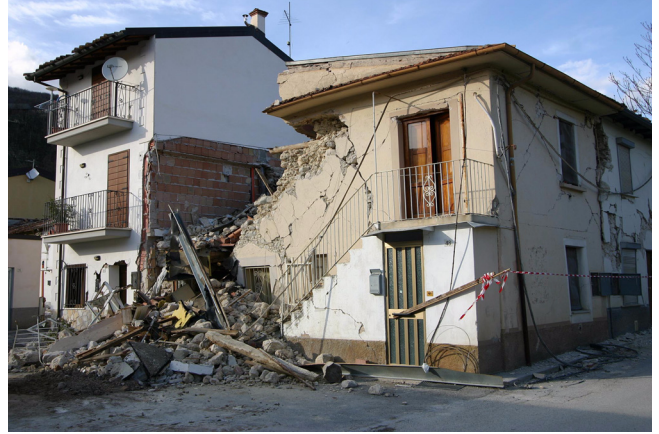
Abb. 8: Eingestürztes Wohnhaus aus Bruchsteinmauerwerk neben einem stehengebliebenen Wohnhaus aus Betonsteinen.
