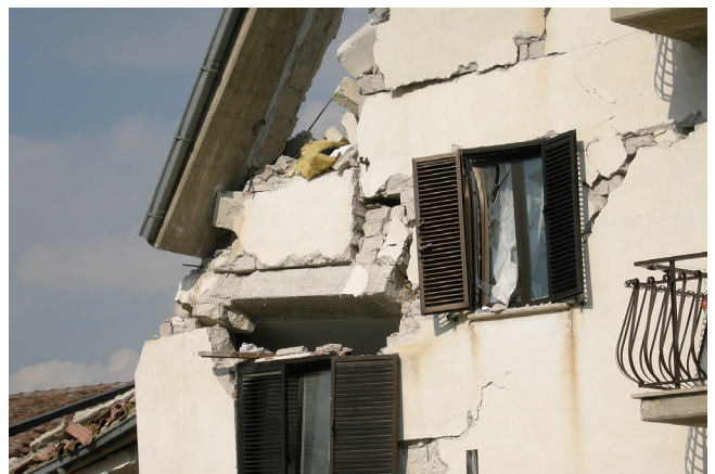
Abb. 24: Nahaufnahme der versagten Gebäudeecke.
